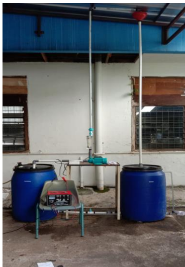
Gambar 1.1 Instalasi Pompa DC
