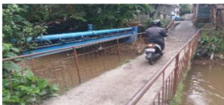
Gambar 1. Kondisi jembatan penyebrangan Cawang eksisting
