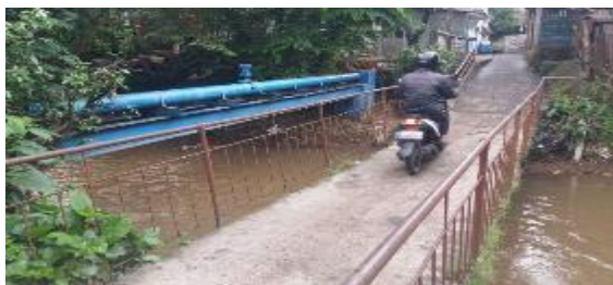
Gambar 1. Kondisi jembatan penyebrangan Cawang eksisting
