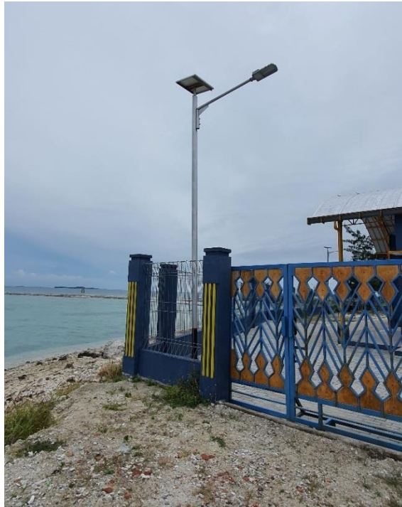
Gambar 5.5. Lampu Penerangan Jalan Dengan Mempergunakan Energi Matahari
