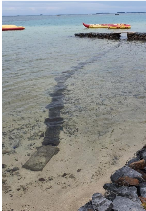
Gambar 5.6. Saluran Kabel Laut Milik PT PLN Untuk Melistriki Pulau Tidung
