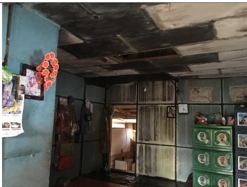
Kondisi rumah warga petambak udang di Dipasena
