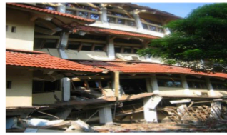
b. Keruntuhan akibat kolom pendek
