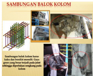
b. Keruntuhan sambungan (Sumber : PUPR )
