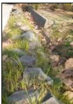
Gambar 6. Saluran tidak terpelihara
