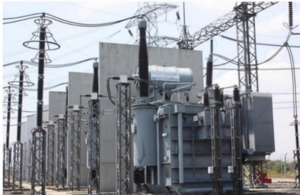
Gambar 5. 24. Transformator tegangan ekstra tinggi (TET).
