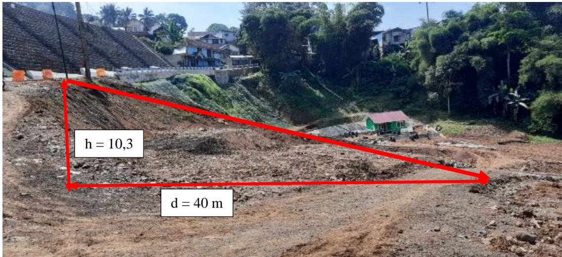
Gambar 4.2. Lokasi Longsor yang cukup meluas di sisi atas dan bawah lereng jalan nasional kecamatan Cugenang Cianjur
