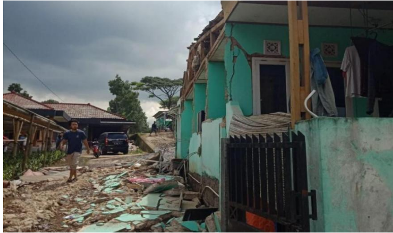
Gambar 1.2. Rumah yang rusak akibat guncangan gempa
