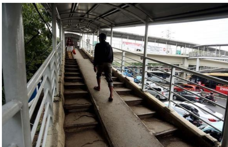
Gambar 2. Kondisi Jalan Jembatan Penyebrangan Orang (JPO) UKI
