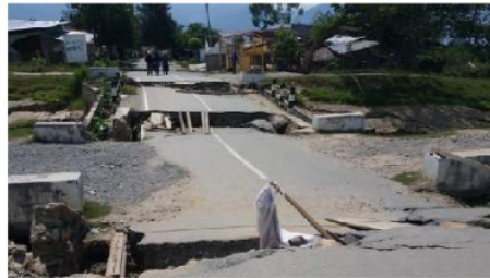
Gambar 7. Liquifaksi yang menghancurkan jalan di wilayah Sigi
