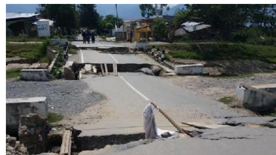
Gambar 7. Liquefaksi yang menghancurkan jalan di wilayah Sigi
