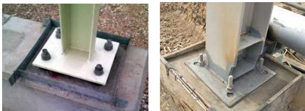
Gambar 37: Foto sambungan pondasi dengan kolom baja IWF, dengan media plat baja dan ankur (Sumber dokumentasi pribadi)
