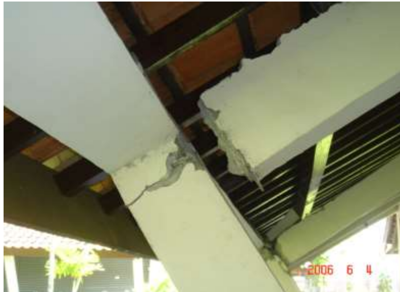
Gambar 34 : Foto kerusakan struktur akibat gempa (Sumber Dokumentasi penulis)
