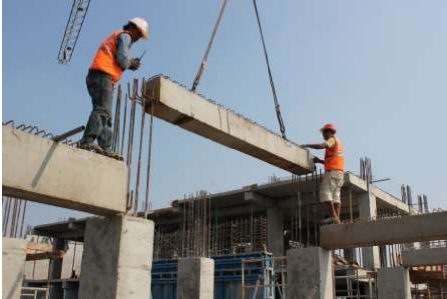
Gambar 7 : Foto contoh konstruksi, pemasangan balok precast, penempatan secara tepat/presisi antara kolom dan balok precast (sumber dokumentasi penulis)
