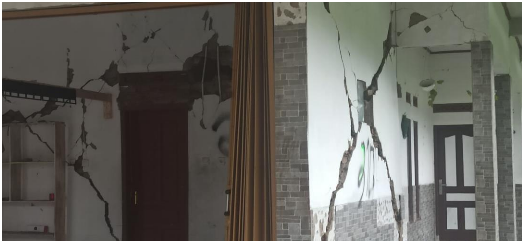
Gambar 2.4. Kretakan dinding yang berbentuk diagonal namun tidak mengalami runtuh
