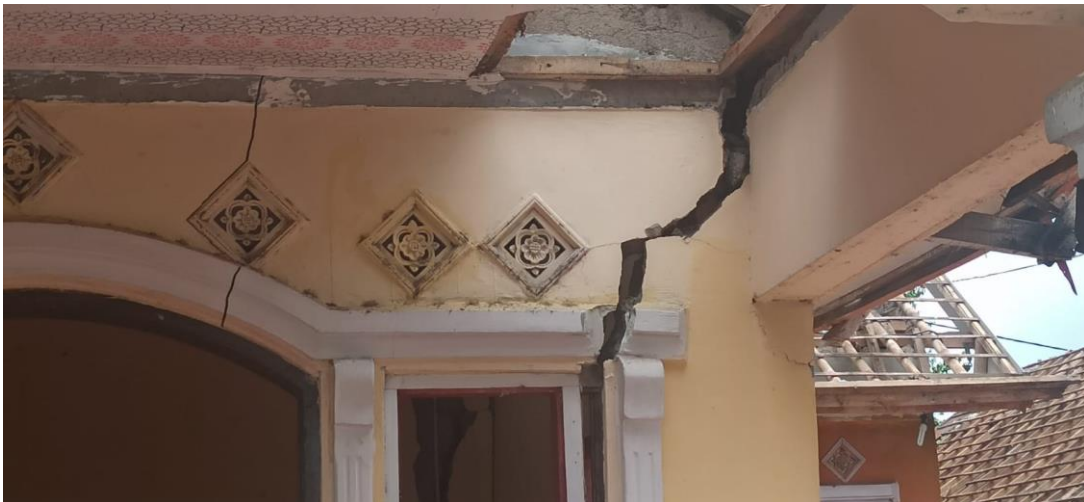
Gambar 2.6. Dinding yang mengalami retak melebar namun belum runtuh
