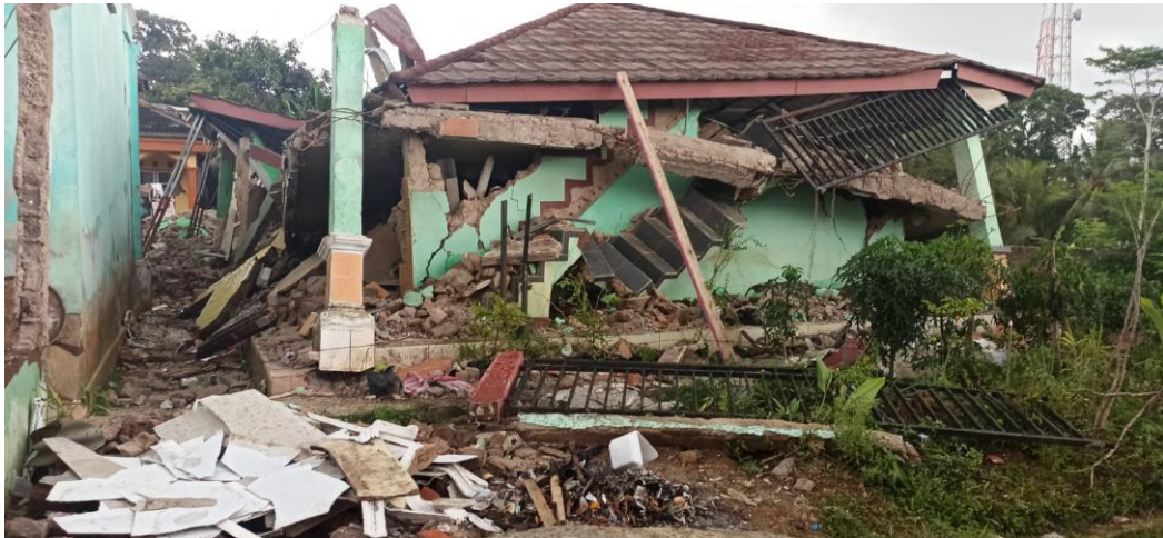
Gambar 2.9. Bagian tangga yang runtuh tanpa adanya penulangan yang cukup kuat.
