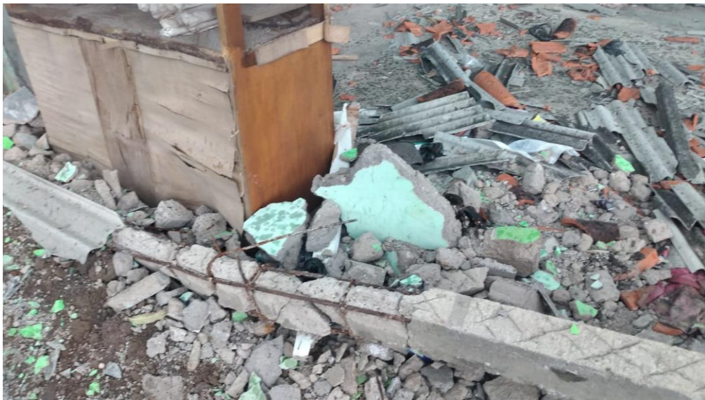
Gambar 2.13. Bagian struktur bangunan berupa kolom yang penulangannya tidak memenuhi syarat kekuatan.
