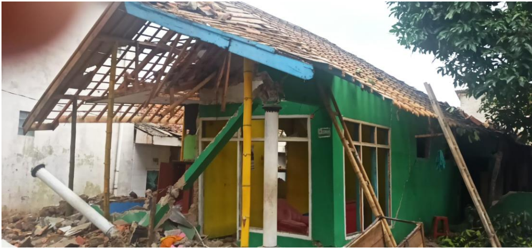
Gambar 2.1. Kerusakan rumah penduduk yang tidak memenuhi syarat kekuatan kolom.
