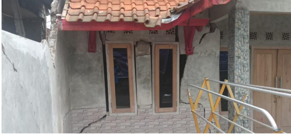
Gambar 2.21. Rumah dengan keretakan dinding yang melebar namun terlihat kolom dan atap yang cukup kuat
