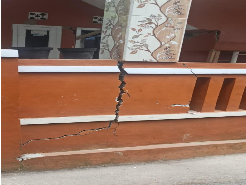
Gambar 2.17. Bagian pagar beton rumah yang mengalami retak lebar
