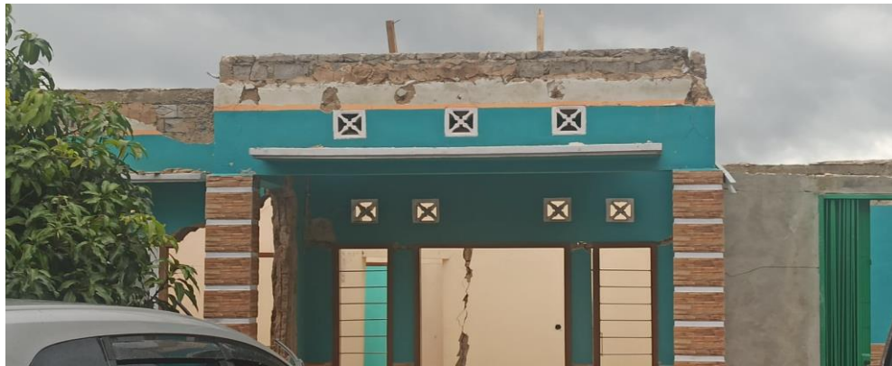
Gambar 2.22. Bagian atap rumah yang runtuh total
