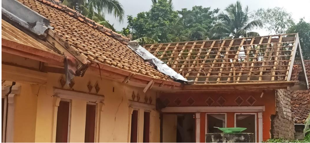
Gambar 2.5. Keruntuhan genteng dan retak dan runtuhnya sebagian dinding
