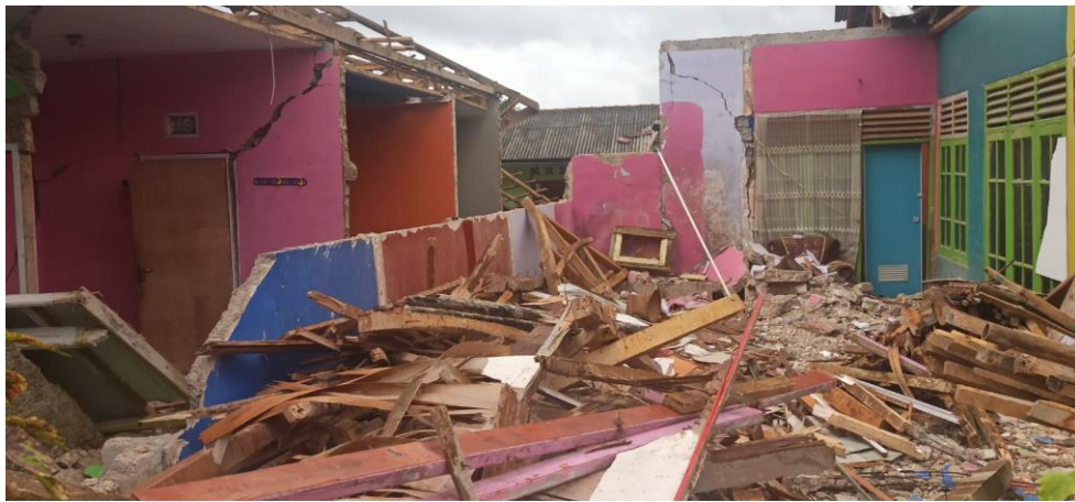
Gambar 2.20. Bagian rumah dari sisi lain yang mengalami keruntuhan pada atap dan dinding
