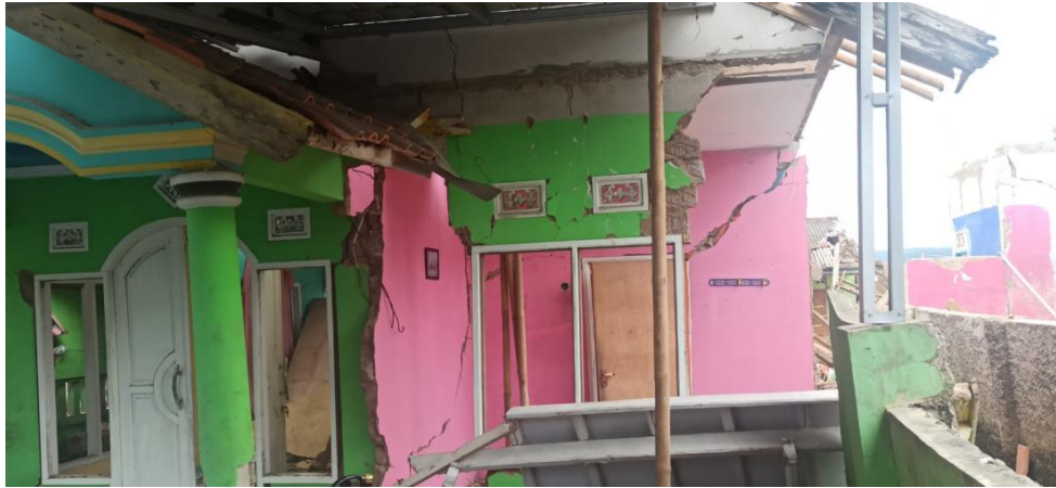
Gambar 2.19. Rumah yang mengalami keruntuhan bagian dinding dengan campuran perekat dan ketebalan yang tidak memenuhi syarat
