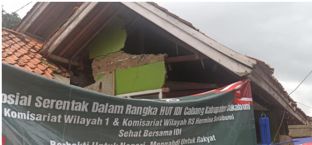
Gambar 2.18. Rumah yang mengalami keruntuhan pada dinding atap
