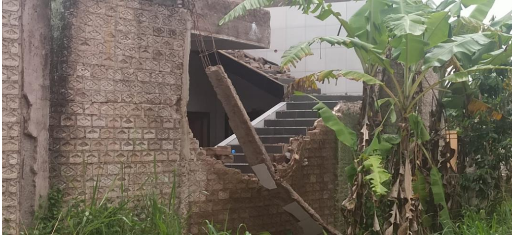
Gambar 2.13. Dinding pembatas dengan kolom yang tidak memenuhi syarat kekuatan
