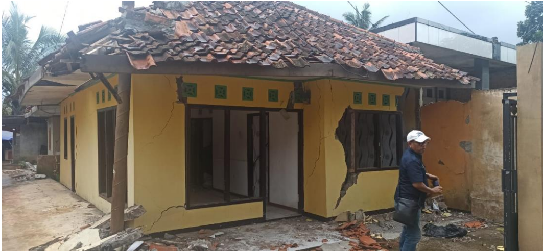
Gambar 2.7. Rumah yang mengalami keruntuhan dan keretakan sebagian dinding
