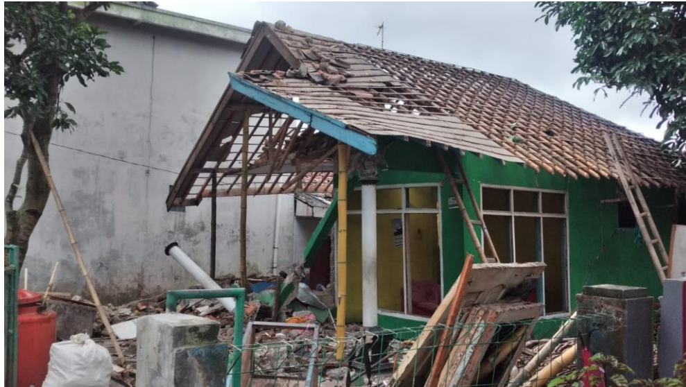
Gambar 2.15. Bagian rumah yang mengalami keruntuhan sebagian
