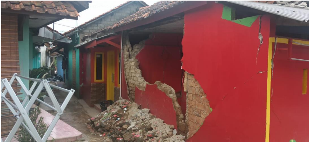
Gambar 2.3. Kerusakan rumah akibat campuran beton yang bercampur tanah dan tidak terlihatnya kolom yang memenuhi syarat.
