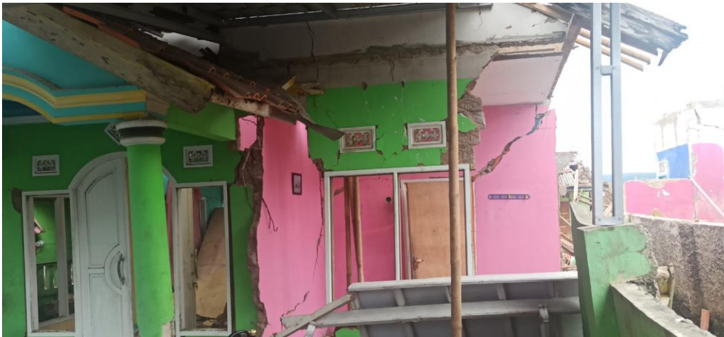
Gambar 2.2. Kerusakan dinding rumah penduduk yang tidak memenuhi syarat campuran beton (bercampur tanah lempung)
