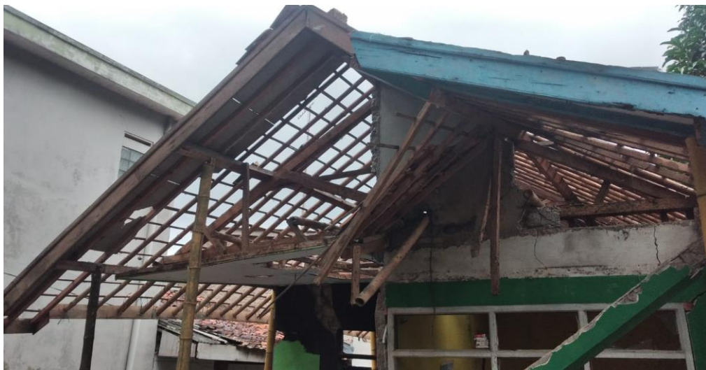
Gambar 2.14. Sambungan kayu pada atap yang tidak terlalu kuat
