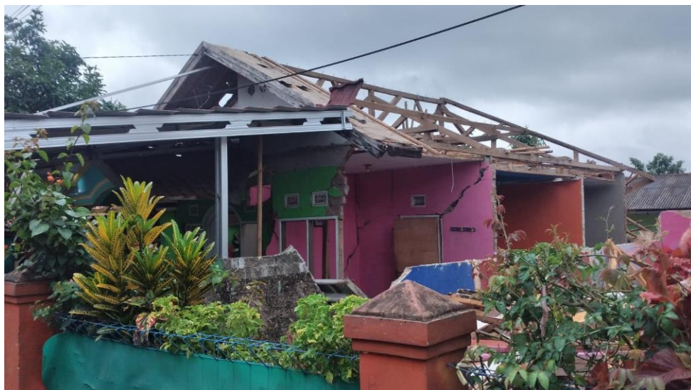
Gambar 2.16. Rumah yang mengalami keretakan lebar pada sebagian bangunan
