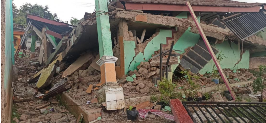
Gambar 2.9. Bagian pondok pesantren lain yang lantainya turun tanpa terikat dengan balok dan kolom
