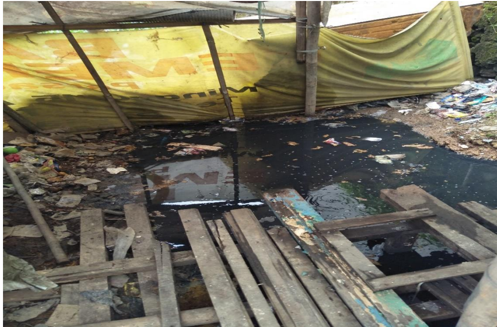
Gambar VI.8. kondisi Jamban TPA Bantar Gebang
