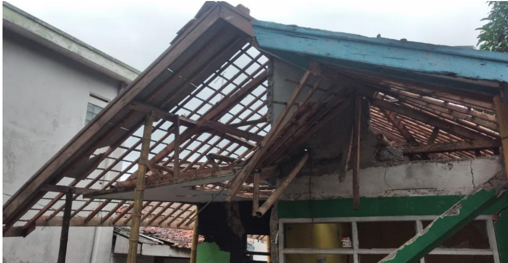
Gambar 49.16. Sambungan kayu pada atap yang tidak terlalu kuat
