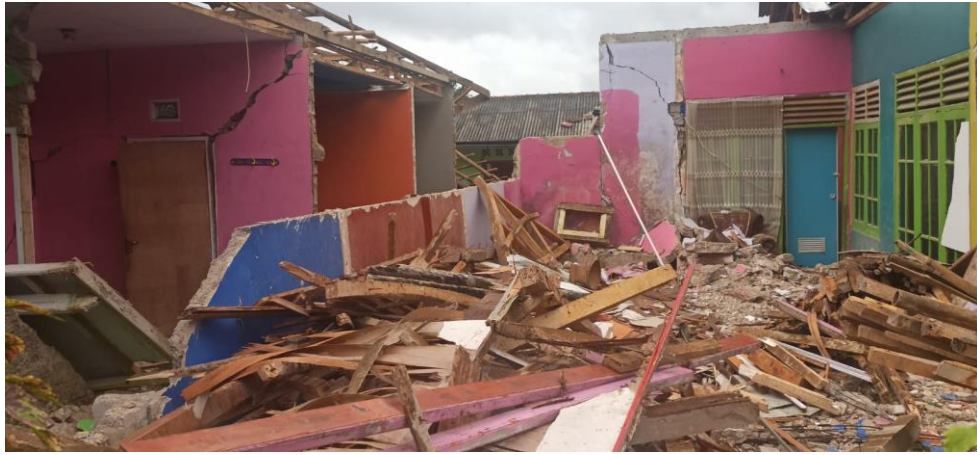
Gambar 49.22. Bagian rumah dari sisi lain yang mengalami keruntuhan pada atap dan dinding
