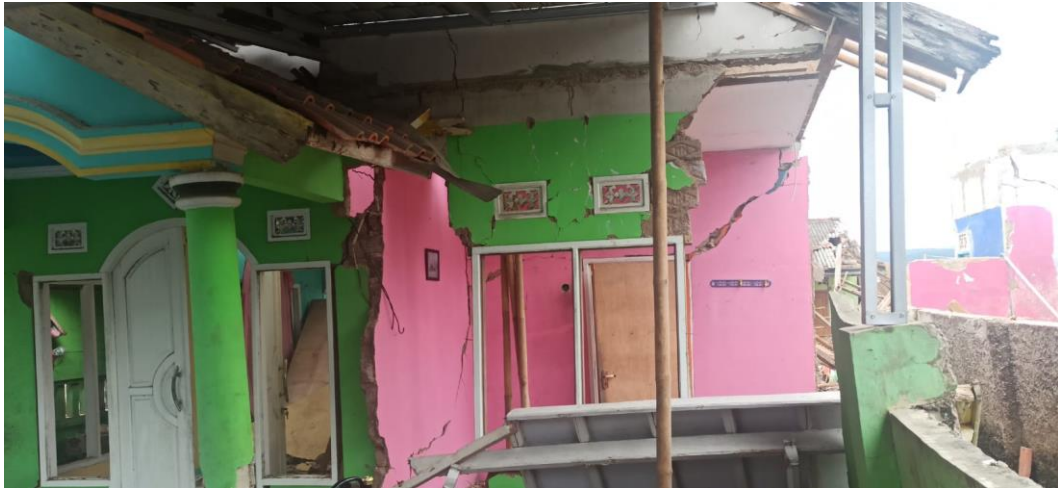
Gambar 49.2. Kerusakan dinding rumah penduduk yang tidak memenuhi syarat campuran beton (bercampur tanah lempung)
