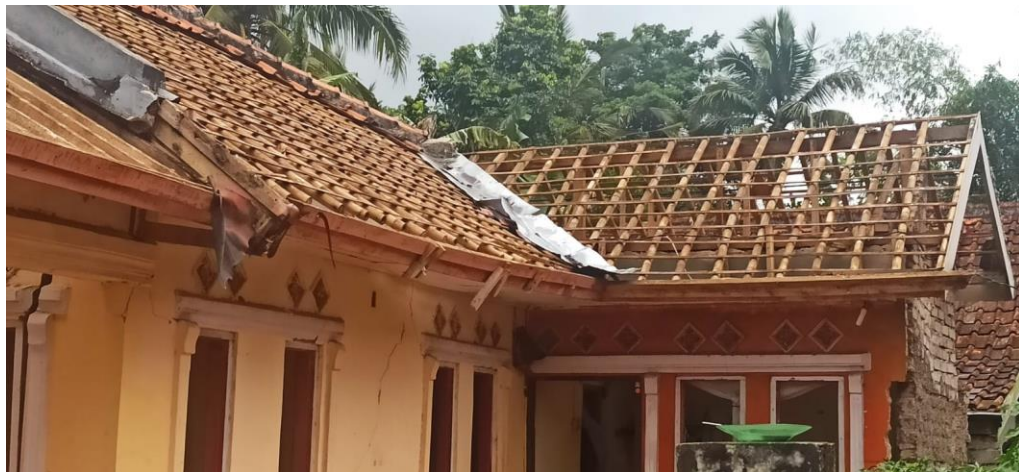
Gambar 49.5. Keruntuhan genteng dan retak dan runtuhnya sebagian dinding
