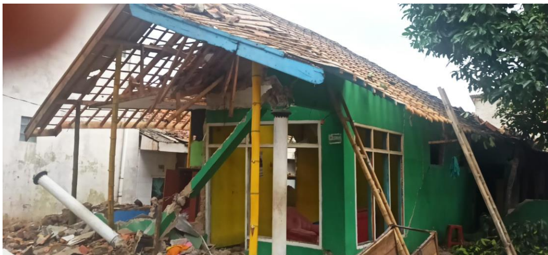
Gambar 49.1. Kerusakan rumah penduduk yang tidak memenuhi syarat kekuatan kolom
