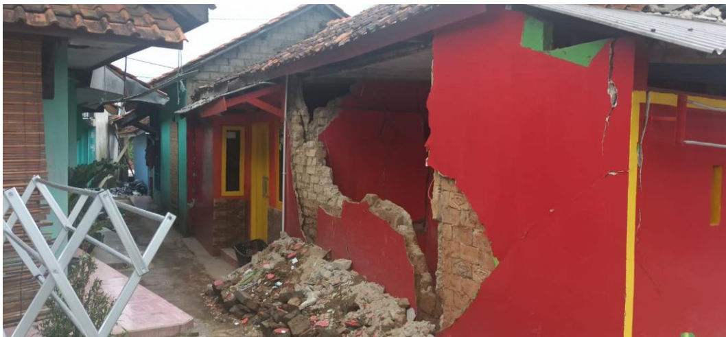
Gambar 49.3. Kerusakan rumah akibat campuran beton yang bercampur tanah dan tidak terlihatnya kolom yang memenuhi syarat
