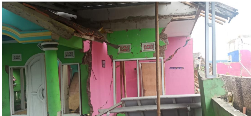
Gambar 49.21. Rumah yang mengalami keruntuhan bagian dinding dengan campuran perekat dan ketebalan yang tidak memenuhi syarat
