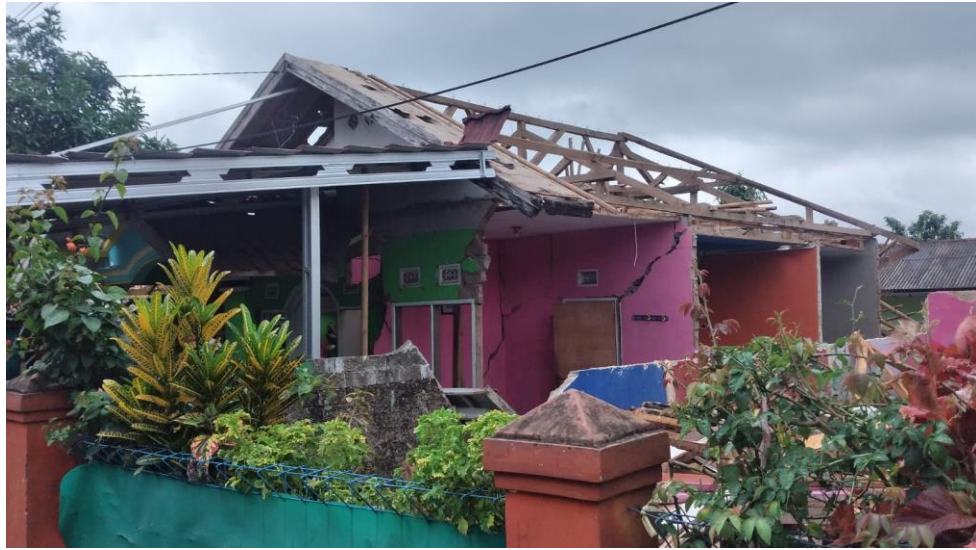
Gambar 49.18. Rumah yang mengalami keretakan lebar pada sebagian bangunan
