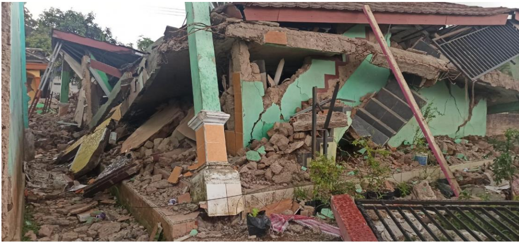
Gambar 49.9. Bagian pondok pesantren lain yang lantainya turun tanpa terikat dengan balok dan kolom
