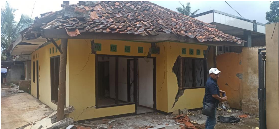
Gambar 49.7. Rumah yang mengalami keruntuhan dan keretakan sebagian dinding
