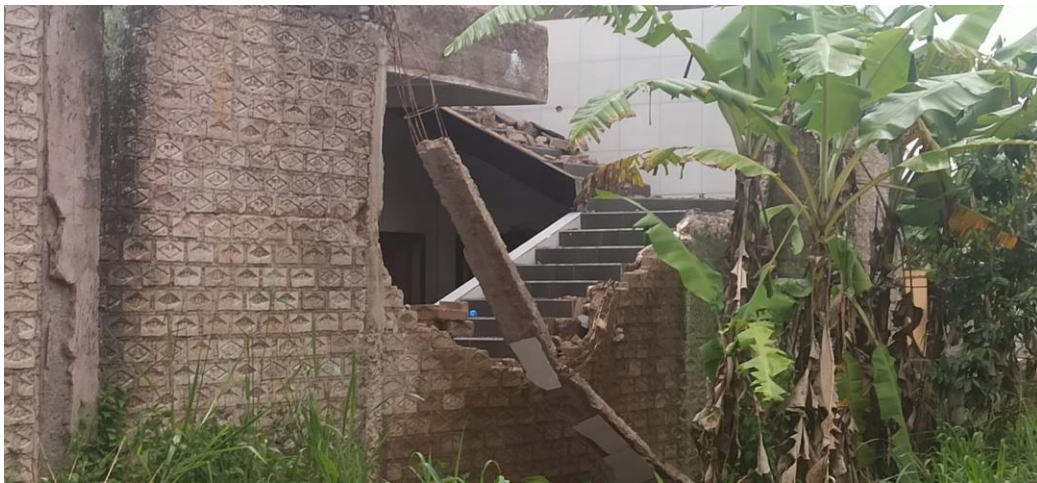
Gambar 49.15. Dinding pembatas dengan kolom yang tidak memenuhi syarat kekuatan
