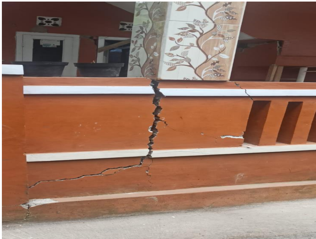
Gambar 49.19. Bagian pagar beton rumah yang mengalami retak lebar
