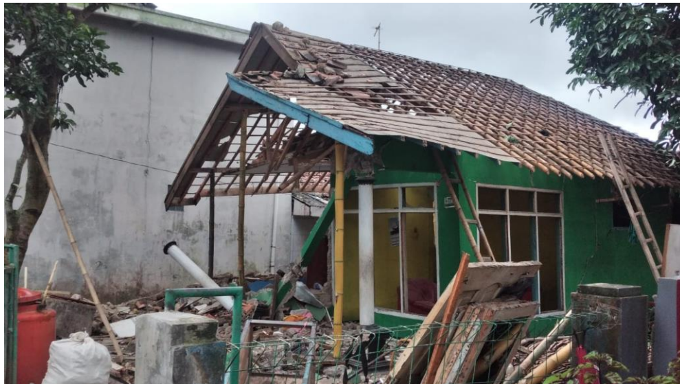
Gambar 49.17. Bagian rumah yang mengalami keruntuhan sebagian
