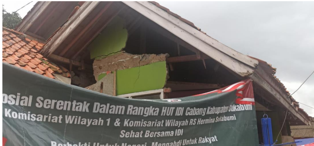
Gambar 49.20. Rumah yang mengalami keruntuhan pada dinding atap
