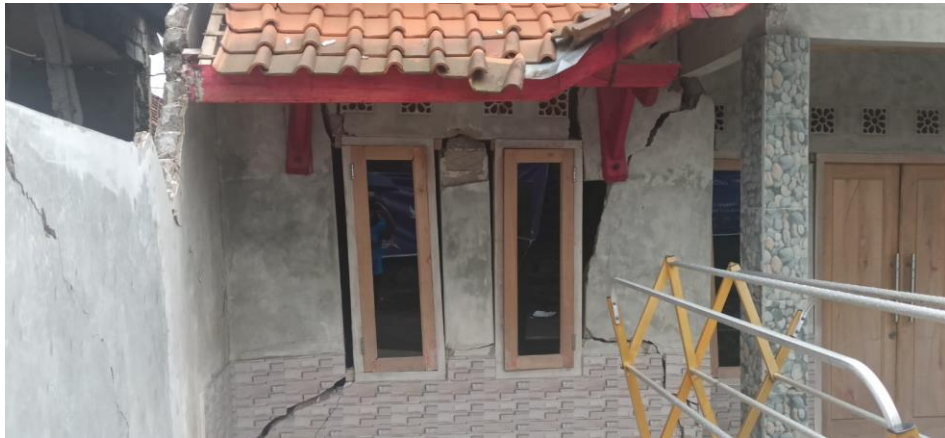
Gambar 49.23. Rumah dengan keretakan dinding yang melebar namun terlihat kolom dan atap yang cukup kuat
