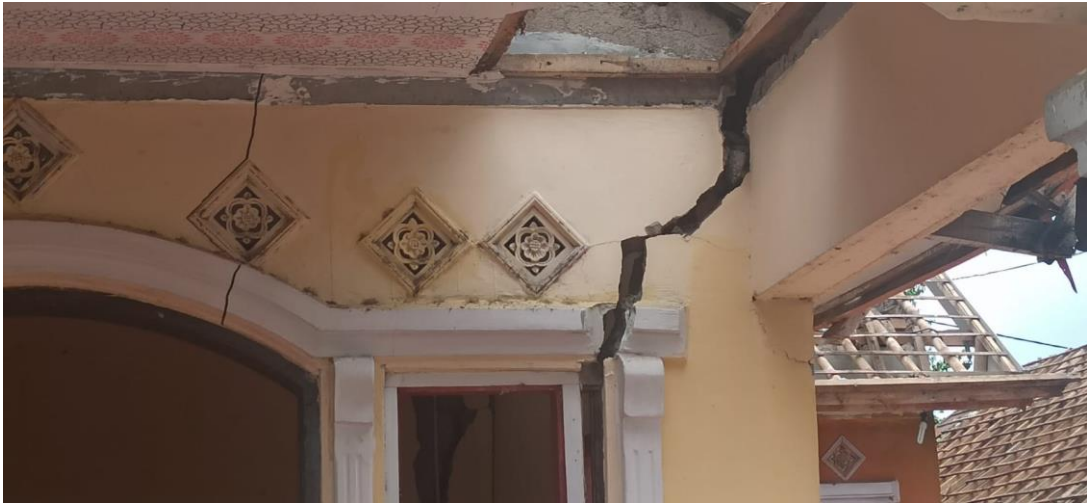
Gambar 49.6. Dinding yang mengalami retak melebar namun belum runtuh
