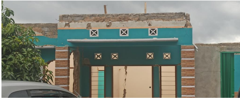
Gambar 49.24. Bagian atap rumah yang runtuh total
