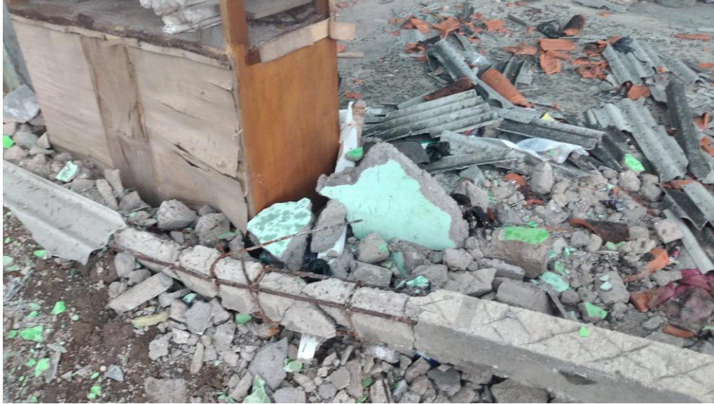
Gambar 49.14. Bagian struktur bangunan berupa kolom yang penulangannya tidak memenuhi syarat kekuatan
