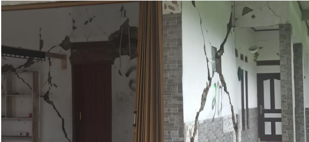
Gambar 49.4. Keretakan dinding yang berbentuk diagonal namun tidak mengalami runtuh
