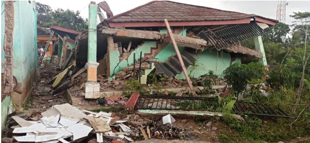
Gambar 49.10. Bagian tangga yang runtuh tanpa adanya penulangan yang cukup kuat
